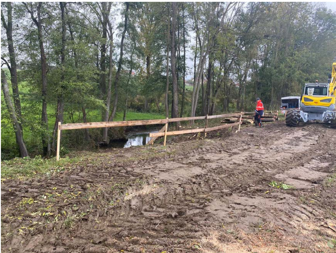
Vorübergehend wurde die Stelle, an der der Hang noch gesichert werden muss, mit einem Holzgeländer versehen. (Foto: WWA München)
