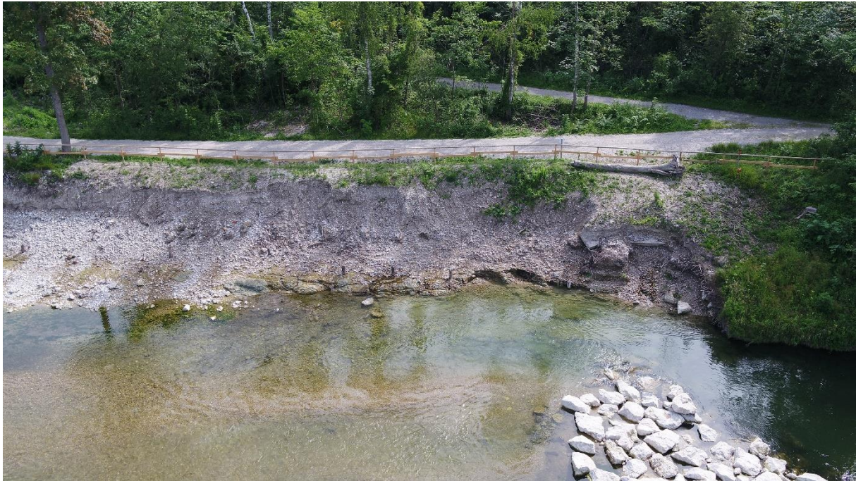
Uferanbruch an der Isar bei Ismaning
