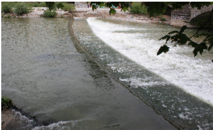
Abb. 1: Absturz der Kleinen Isar oberhalb der Corneliusbrücke - fehlende ökologische Durchgängigkeit
