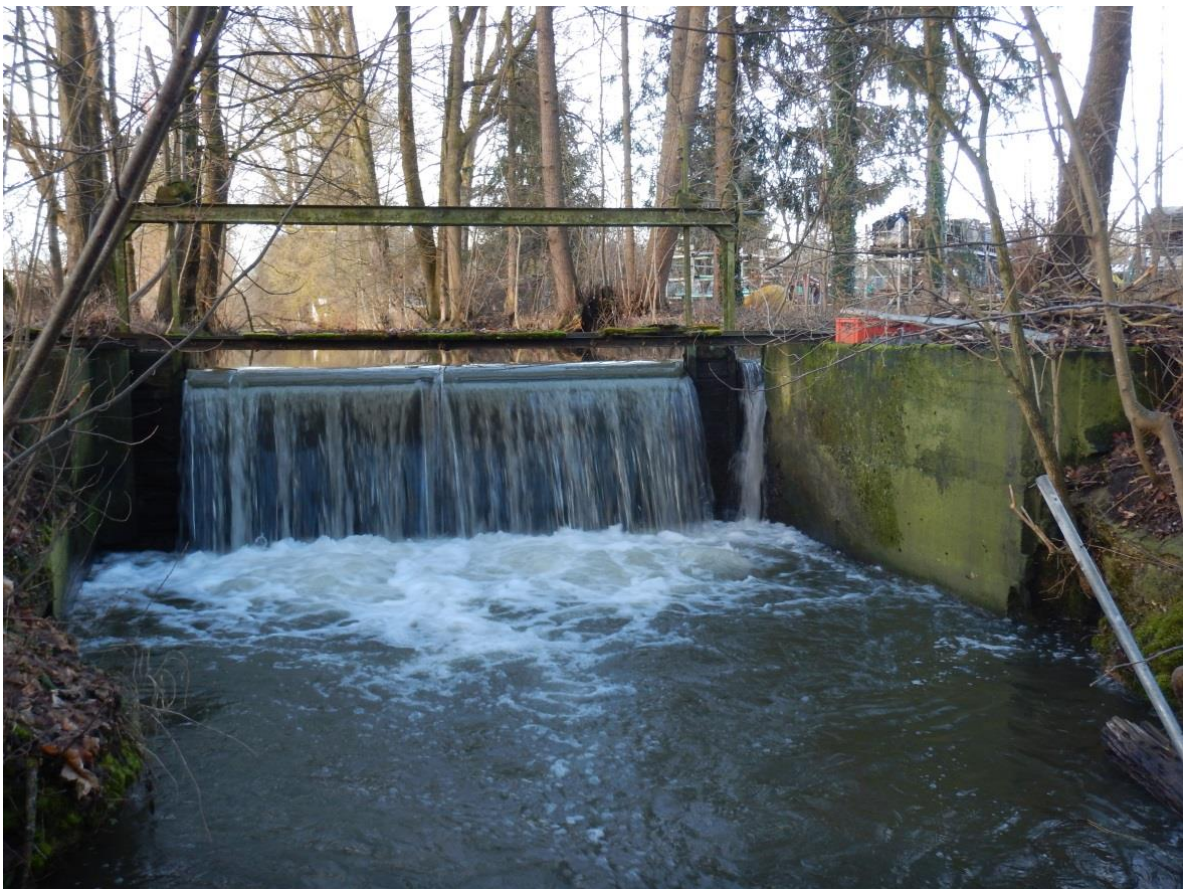
Abb. 2: Fehlende Durchgängigkeit durch ein Querbauwerk bei Fkm 11,7
